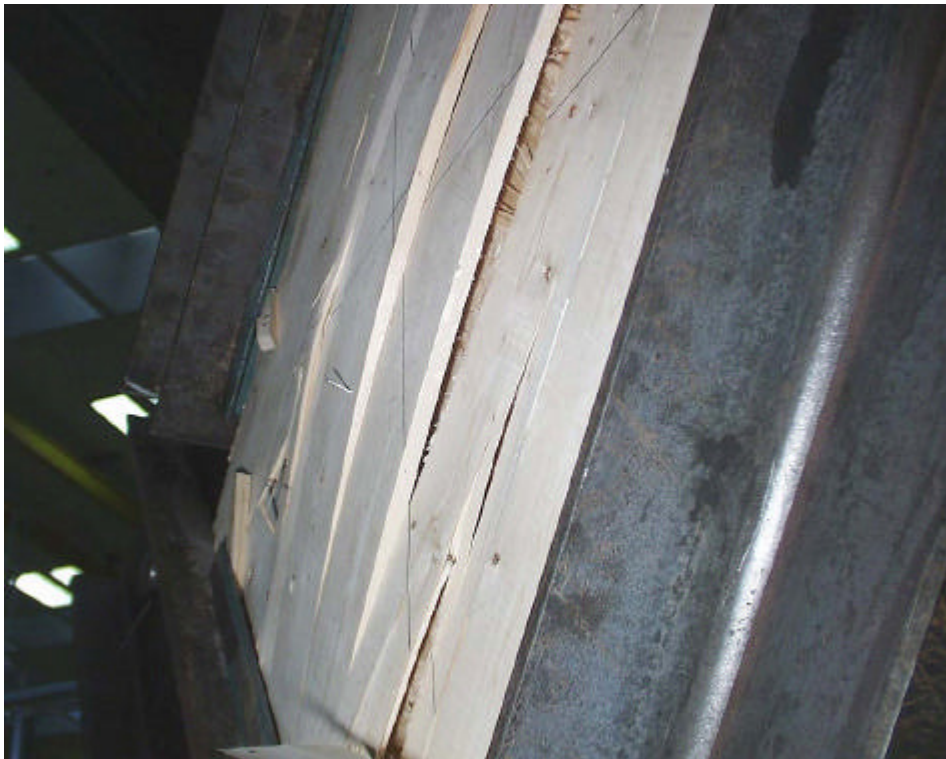
Bild 4.7: Versagen der Leimfugen und Ausknicken einzelner Bretter der äußeren Brettlagen
