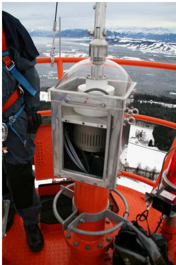
Bild 3.3: Sensoren zur Messung der Blitzströme an der Spitze des Peißenbergturmes
