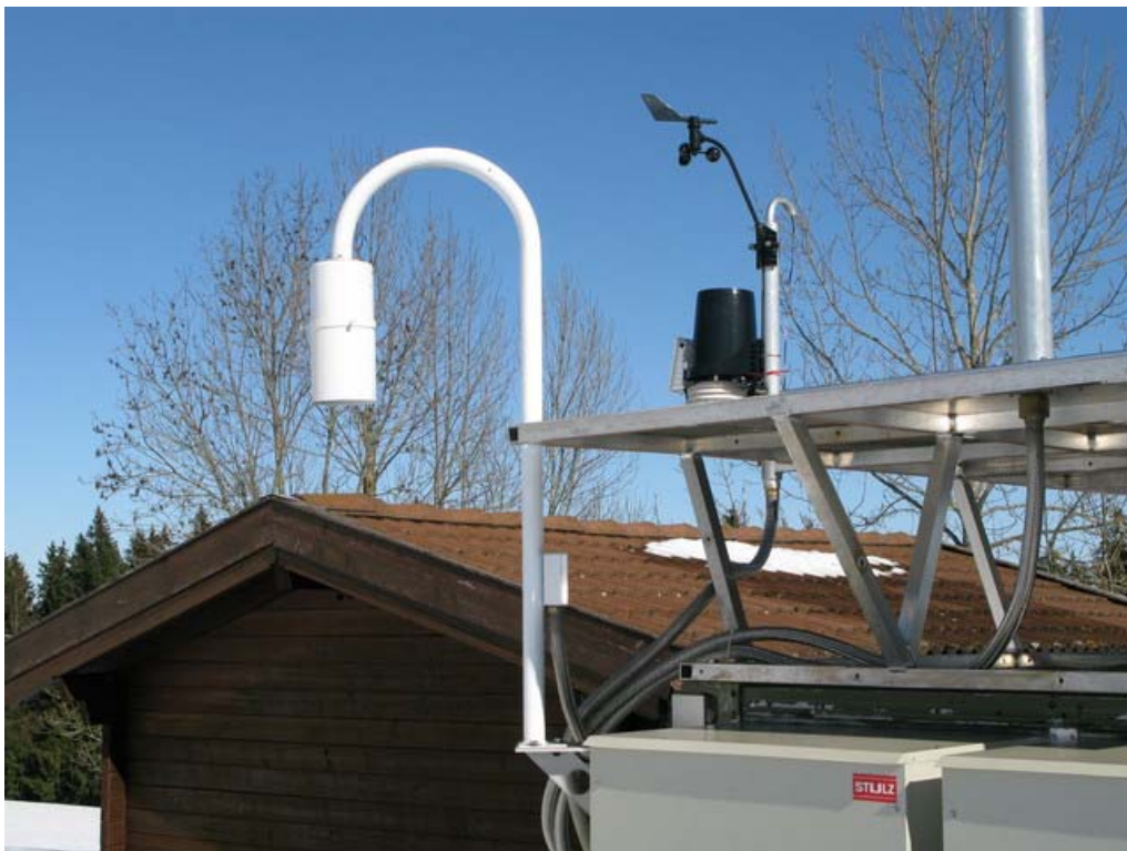
Bild 3.15: Feldmühle, Wetterstation und E(t)-Sensor
